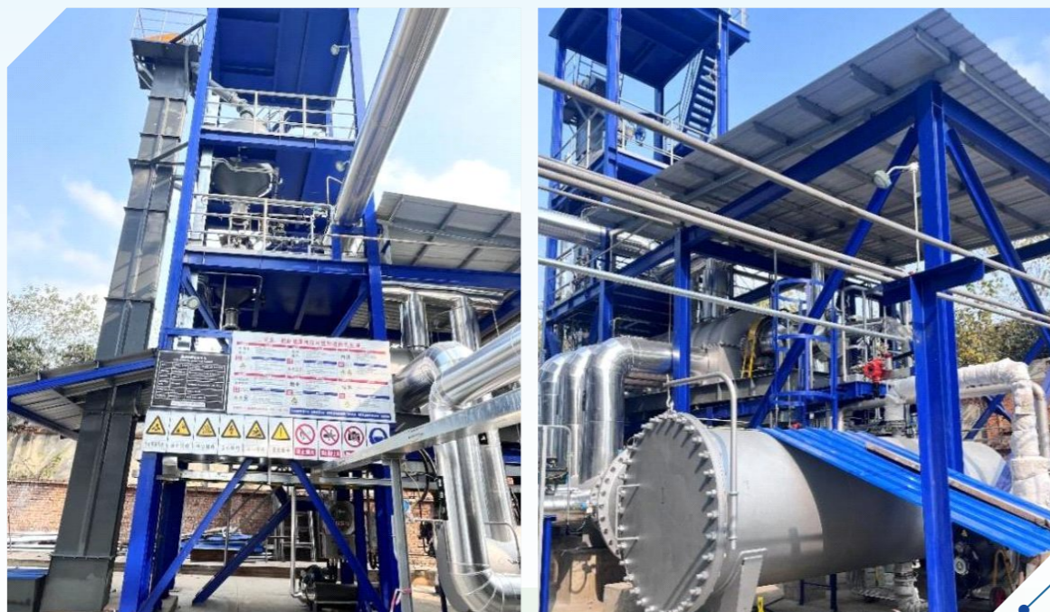
2025年东方锅炉自主开发了连续进出料有机固废绝氧热解技术，建设了一套公斤级/h回转式热解小试装置和一座可实现自供热的100千克/小时回转式热解中试试验台，并完成农林生物质等原料的公斤级热解小试验证。
