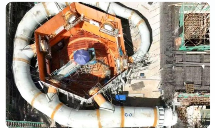
世界首台500兆瓦冲击式水电机组配水环管
